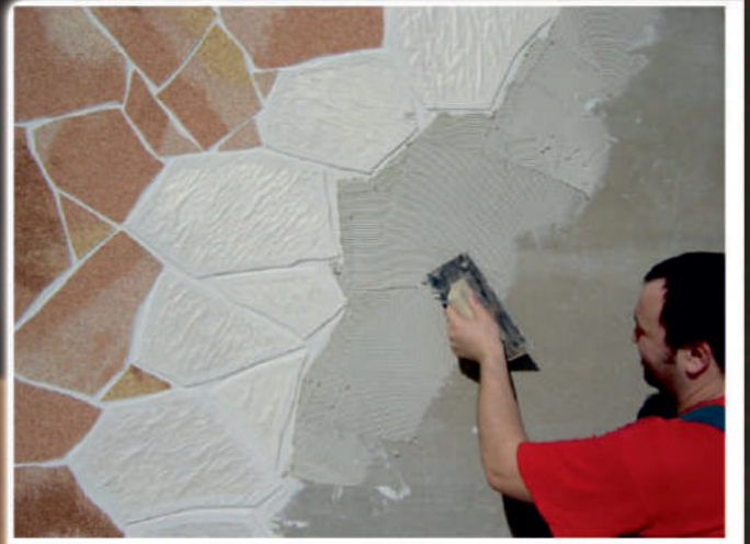
2. Tragen Sie den Kleber mit einer Zahnkelle in einer Dicke von 3-4 mm auf die Fliesen auf.
